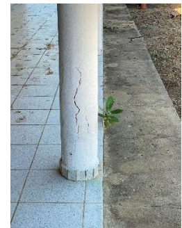
Sanierung wird nötig
